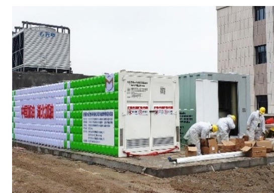
第一代应急处理成套装备现场（黄冈市妇幼保健院）
